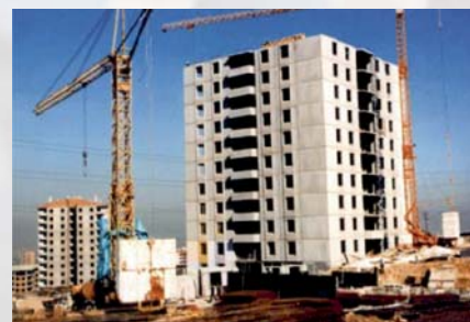
Les demi-produits en construction des bâtiments à plusieurs étages en Ankara, en Turquie, fabriqués sur le chantier dans les batteries de banches verticales
